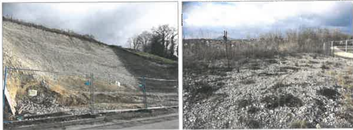
Abbildung 7: Teilfläche 4; Baustelle (links) mit temporärer Schotter-Brachfläche am Oberhang (rechts) (Fotos: HPC AG, 02.01.2019)
